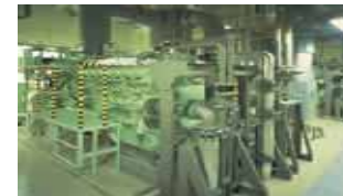
1,000kWクラス ガスエンジン発電設備
